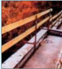
Geklemmter Seitenschutz. Fußwehren fehlen. Die Attika kann als Ablagefläche missbraucht werden
