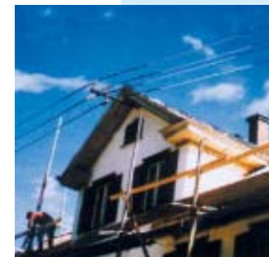
Elektrische Freileitungen werden im Arbeitsbereich für Dacharbeiten von den EVU meist kostenlos geschützt. Das Dachgerüst auf diesem Bild entspricht nicht den Erfordernissen
