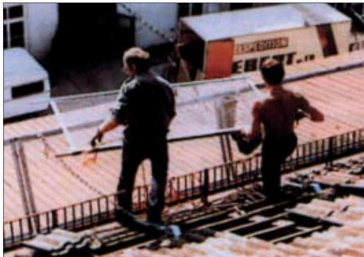
Stabiles Dachschutzgitter, rückverankert und gegen Ausheben gesichert
